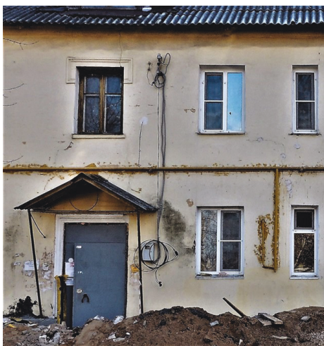
Рис. 2. Трещины в вертикальных створах оконных и дверного проемов, рассекающие продольную стену по всей высоте на участке в осях «В/9-7». Раскрытие всех трещин одинаковое по всей длине
