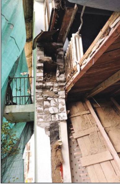
Рис. 7. Наружная и внутренняя версты колодцевой кладки продольной стены, ориентированной по оси «А», не перевязаны между собой ни горизонтальными кирпичными диафрагмами, ни арматурными сетками (то же см. на рис. 6, 8 цв. вклейки). Надоконные перемычки в наружных стенах отсутствуют
