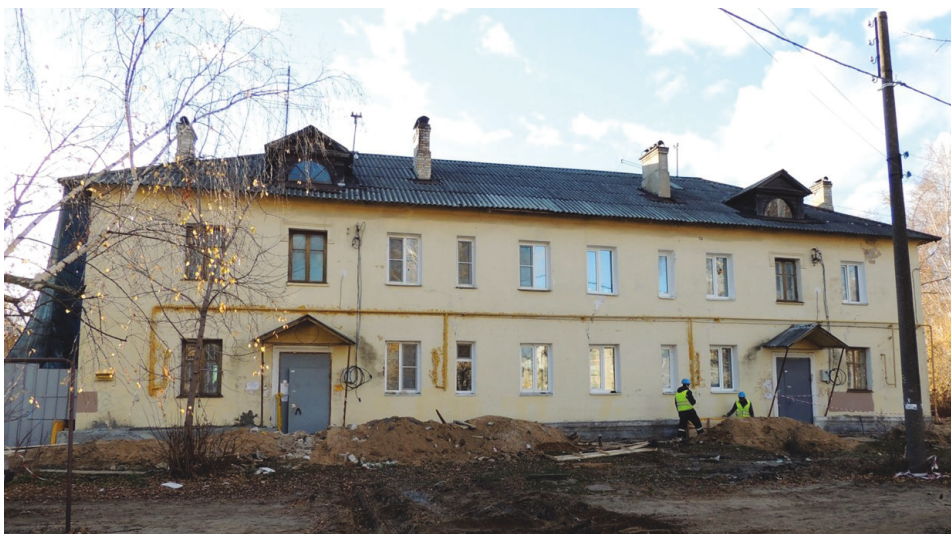
Рис. 1. Дом № 10 на ул. Махалова, стена дворового фасада. Трещины рассекают стену по всей высоте в вертикальных створах, проходящих через пары оконных проемов 1-го и 2-го этажей, расположенных друг над другом (рис. 2, 3 цв. вклейки)
