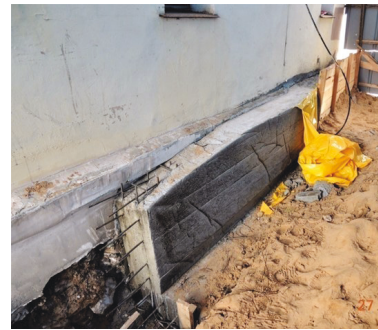
Рис. 13. Деформация железобетонной конструкции одностороннего уширения фундамента на участке в осях «11/А-В» до набора бетоном проектной прочности
