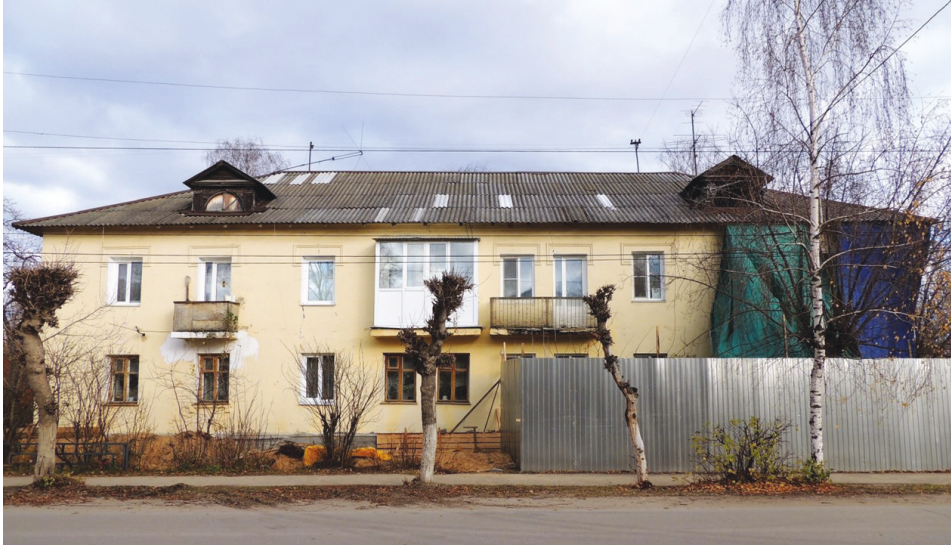
Рис. 4. Наружная продольная стена, ориентированная по оси «А». Трещины рассекают стену по всей высоте в вертикальных створах, проходящих через пары оконных проемов 1-го и 2-го этажей, расположенных друг над другом. Раскрытие трещин одинаковое. Характер образования и расположения трещин в наружных стенах указывает на то, что они не являются результатом неравномерной осадки грунтового основания и опирающегося на него здания
