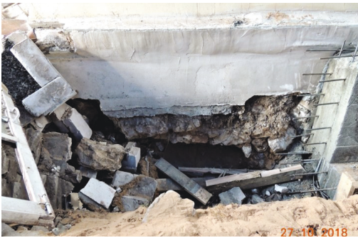
Рис. 12. Пустота под фундаментом обрушившегося фрагмента торцевой стены, на участке в осях «11/А-В», не обнаруженная подрядчиком при обследовании фундаментов. Отрывка траншеи у стены на проектную глубину 1,2 м, для устройства одностороннего уширения фундамента, привело к обрушению торцевой стены
