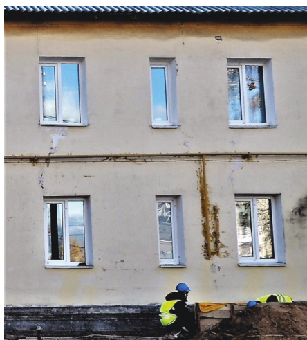
Рис. 3. Трещины рассекают продольную стену по всей высоте на участке в осях «В/6-3». Характер траекторий развития трещин указывает на отсутствие перемычек над проемами
