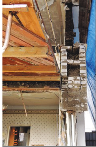
Рис. 8. Длинные доски несущих балок перекрытия потеряли опору при обрушении стены и упали вниз вместе с дощатой подшивкой. Короткие доски балок удержались от обрушения за счет совместной работы с «раскосым» дощато-гвоздевым настилом, образующим жесткий горизонтальный диск перекрытия
