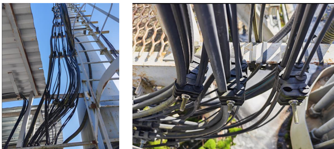
Рис. 2. Общий вид кабельной трассы на опоре С3
