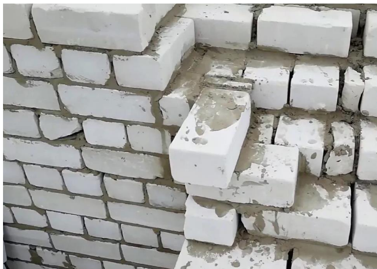
Рис. 2. Каменная кладка, выполненная низкоквалифицированным каменщиком (2–3 разряд)
