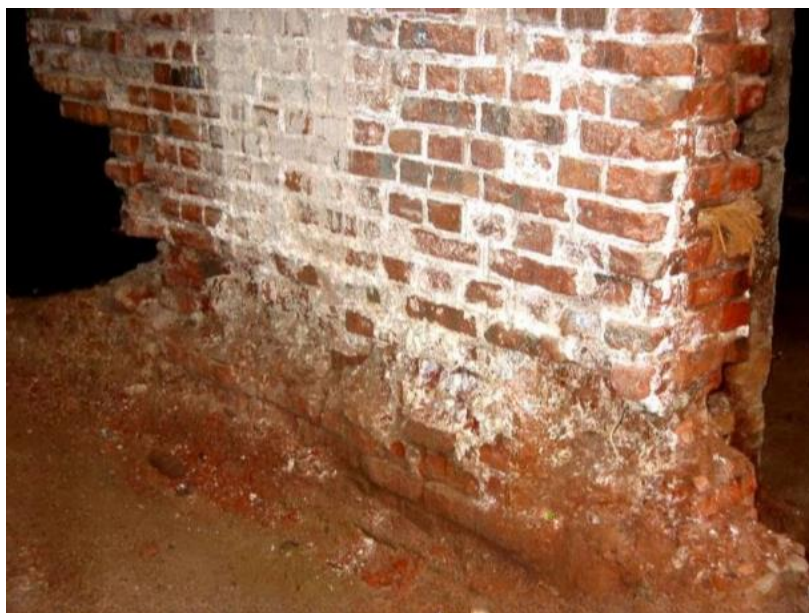
Рис. 8. Образование усадки, эрозии и вымывание раствора в толстых швах
