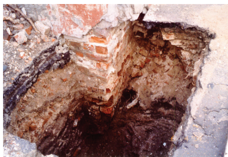
Рис. 9. Шурф № 15. Царская часовня. Слева: стена, ориентированная вдоль оси «Ж»; справа – вдоль оси «2». Кладка нижней части фундамента повреждена при проходке шурфа. Через несколько дней после вскрытия на дне шурфа появилась грунтовая вода
