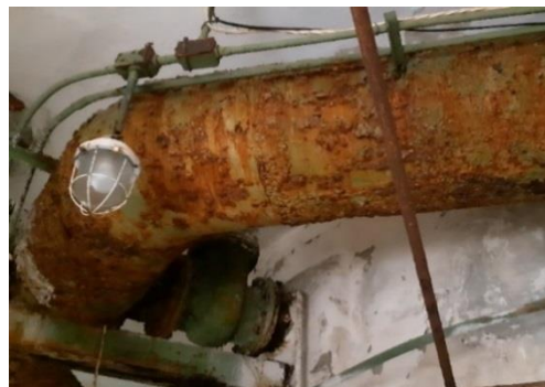
Рис 2. Стальной трубопровод на ВОС-1
